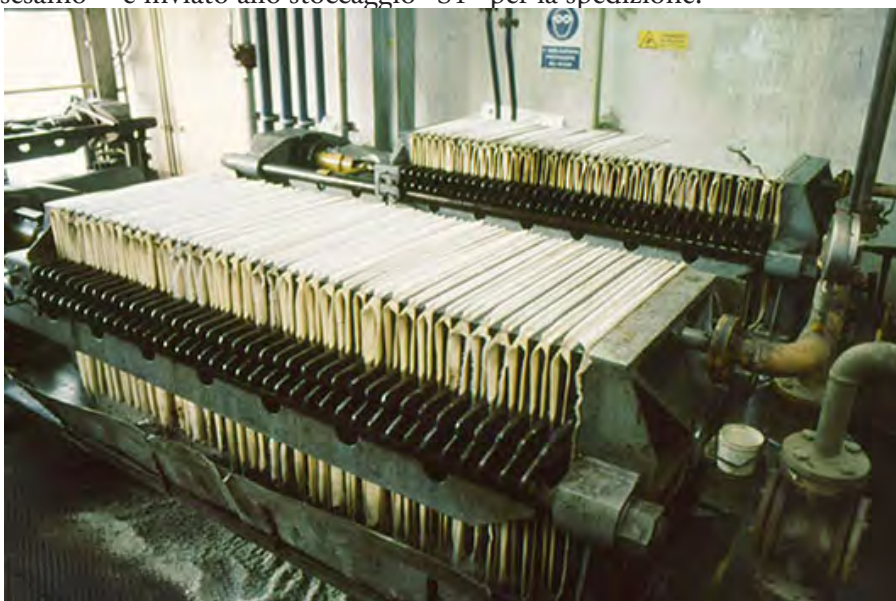
Fig.50 Filtro pressa con teli filtranti
