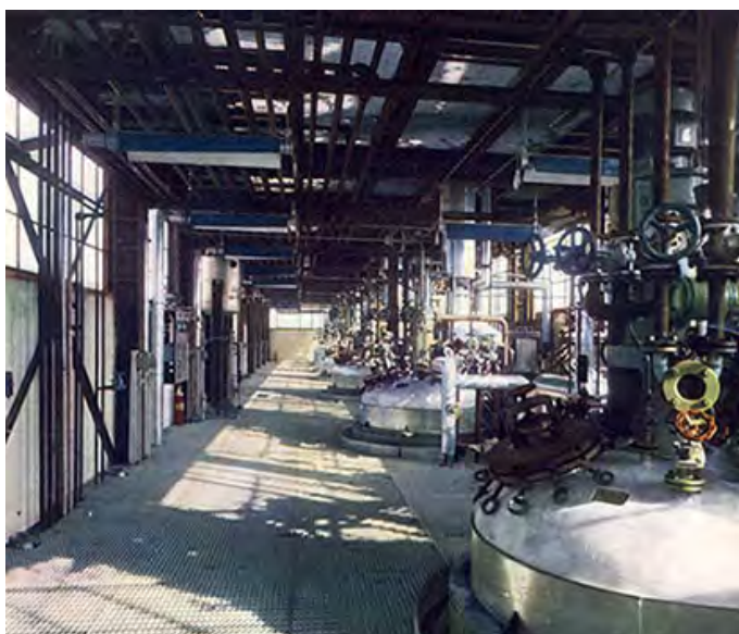
Fig. 53 Interno del reparto Oleochimico, piano testa dei reattori
